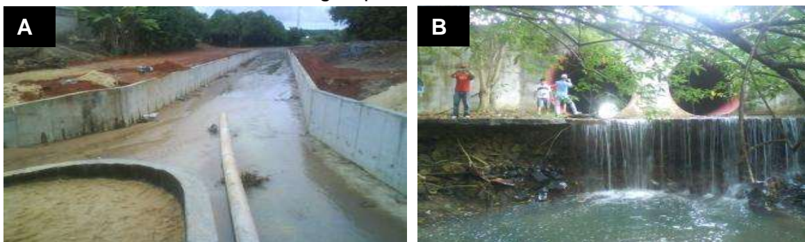
Figura 4 - Obras em Boa Vista: (A) encontro dos igarapés Tiririca e Jararaca; (B) igarapé Mirandinha
