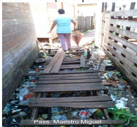
Figura 3: Falta de manutenção nas pontes das áreas de ressacas
